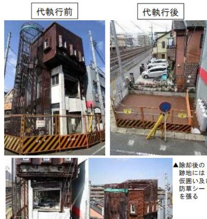
▲窓ガラスや外壁材、屋根材の一部が崩落
