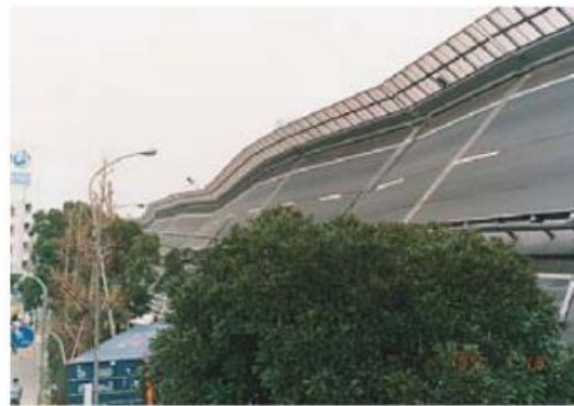
阪神高速道路の高架橋の倒壊
